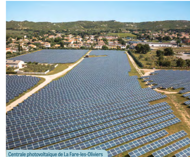
Centrale photovoltaïque de La Fare-les-Oliviers
